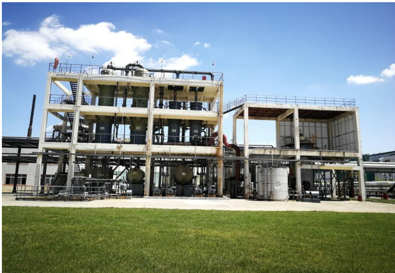
焚烧装置全景
