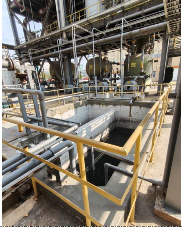
焚烧炉区域废水收集池
