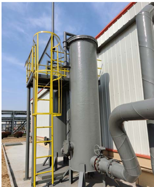
危废仓库废气活性炭吸附装置
