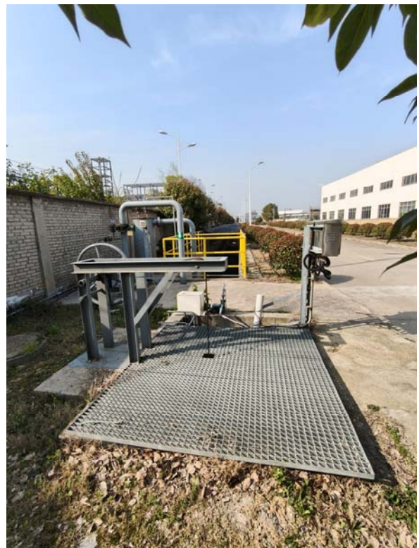
雨水紧急切断设施
