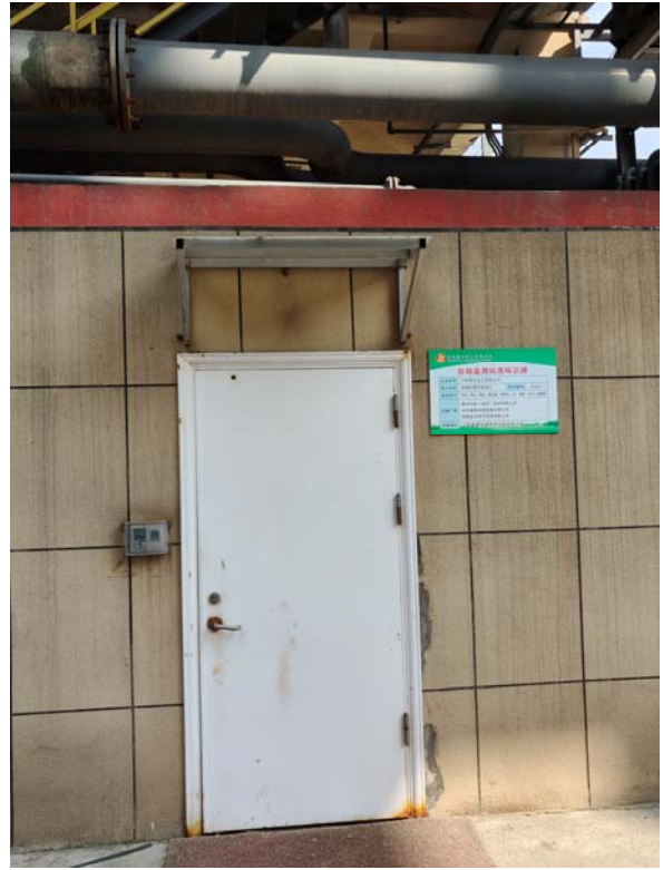
焚烧炉在线监测设备房
