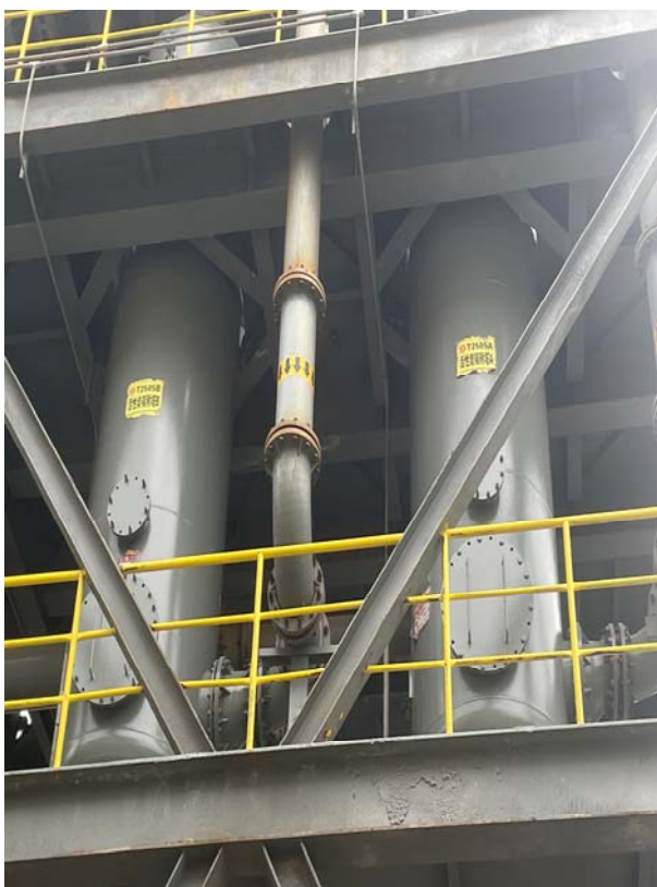
焚烧炉废气活性炭吸附装置
