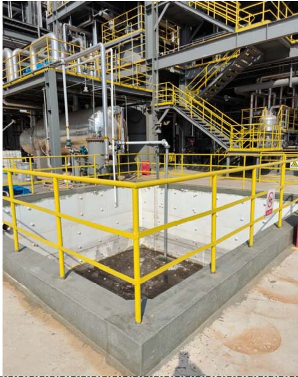
TFE 装置 II 废水收集池
