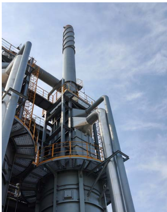
过热炉废气排气筒
