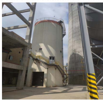
石灰石粉仓布袋除尘器
