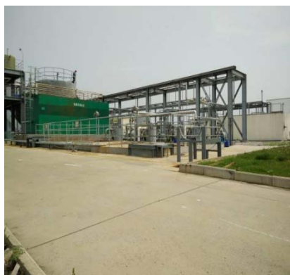
厂区污水处理站
