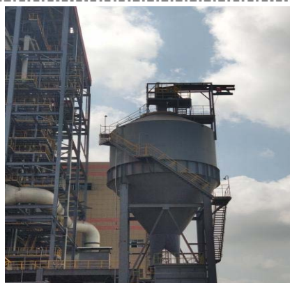
渣仓布袋除尘器
