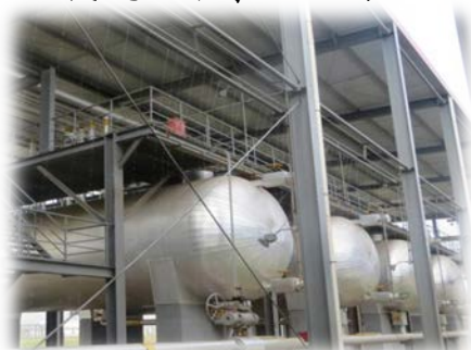
启动碱喷淋设施
