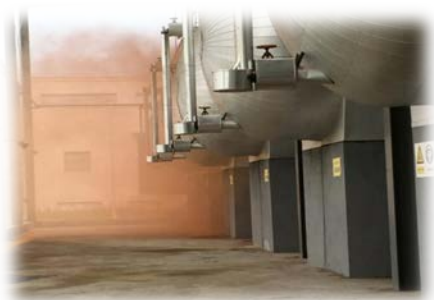
氯气泄露事故现场
