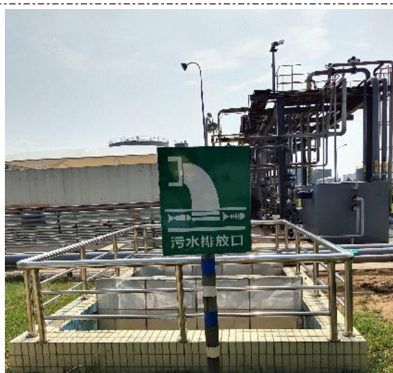
废水排放口标识牌
