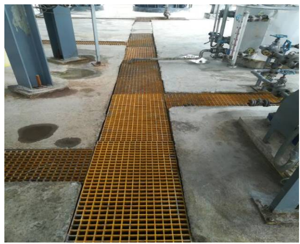
车间跑、冒、滴、漏废水收集沟
