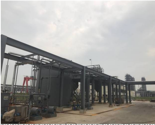
污水处理设施
