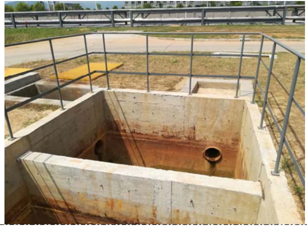
车间废水收集池
