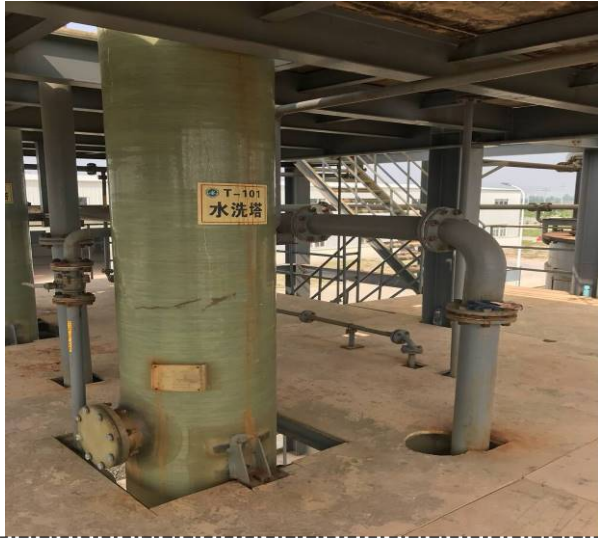
反应系统水洗塔
