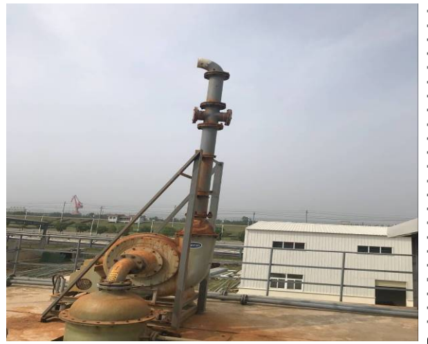
反应系统排气筒
