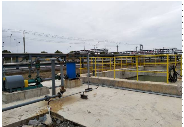
车间废水收集池
