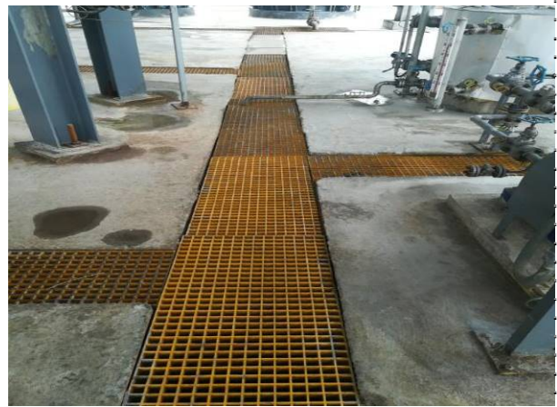
车间跑、冒、滴、漏废水收集沟
