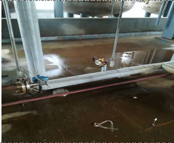
车间废水收集池
