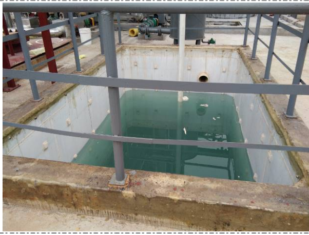
车间废水收集池
