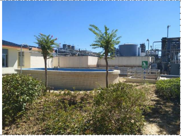
厂区污水处理站
