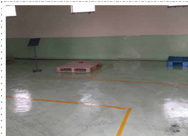
危废密闭、分区暂存措施
