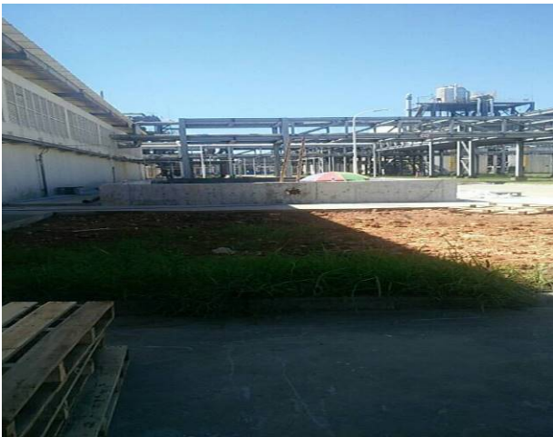
车间废水收集池
