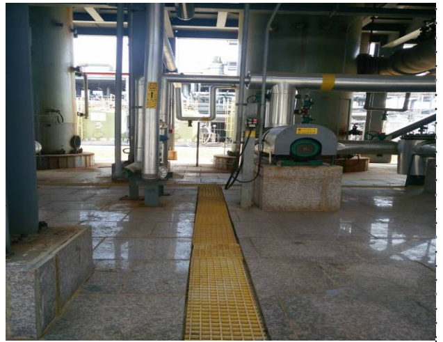
车间跑、冒、滴、漏废水收集沟
