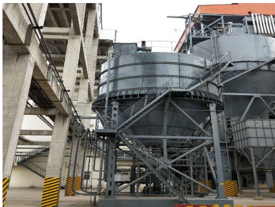
炉内脱硫设施
