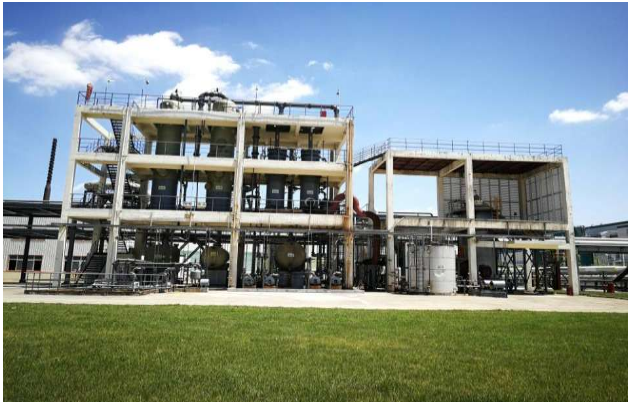
焚烧装置全景
